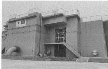
ベトナム国アンソン浄水場のU-BCF施設
